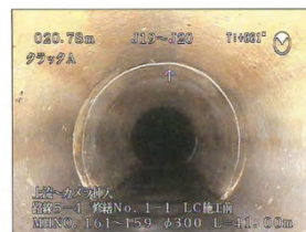
写真1 発見したクラック
