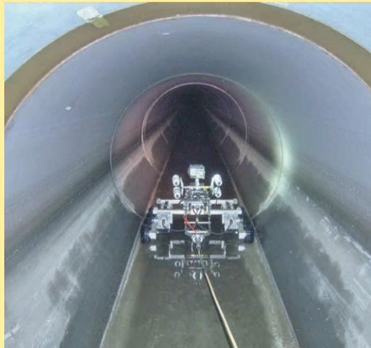
下水道管の点検ロボット。
